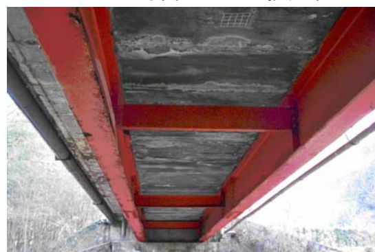
写真-2 施工前・床版損傷状況
