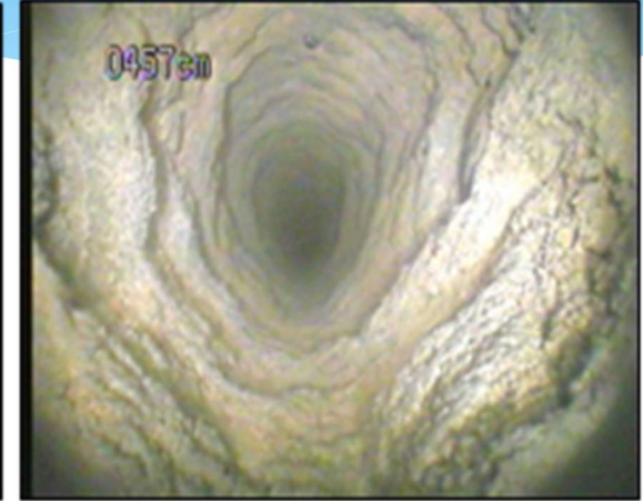
管内閉塞状況
