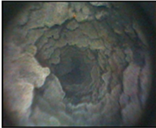
管内錆瘤発生状況
