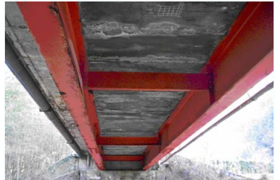
写真-2 施工前・床版損傷状況
